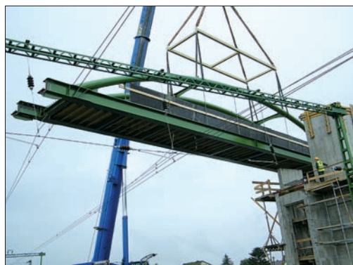
14. ábra: A első ütemben épülő kisebbik szélső nyílás zsaluzattal való beemelése a felsővezeték fölé
