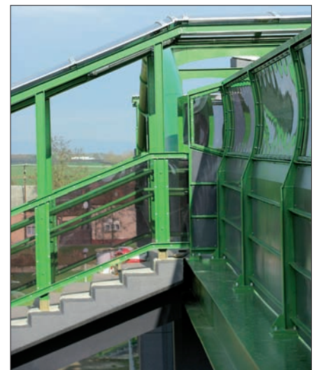
11. ábra: Vasút feletti 2,00 m magas érintésvédelmi gyalogoskorlát és a vasbeton lépcsőkar végződése, mely konzolos kialakítása miatt nem támaszkodik neki az acélszerkezetnek
