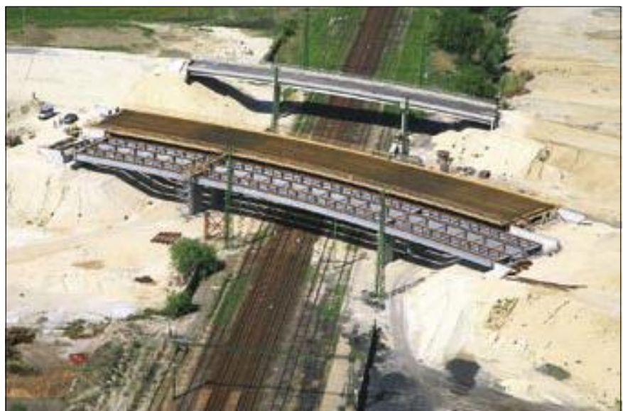
1. kép: A 147 j. híd helyszíne madártávlatból: a jobb pálya vasbeton pályalemezének betonacél-szerelése kész, a háttérben a 147k jelű felüljáró, mely a kedvezőbb keresztezési szög és keskenyebb felszerkezet miatt „még” megoldható volt feszített beton tartók alkalmazásával
