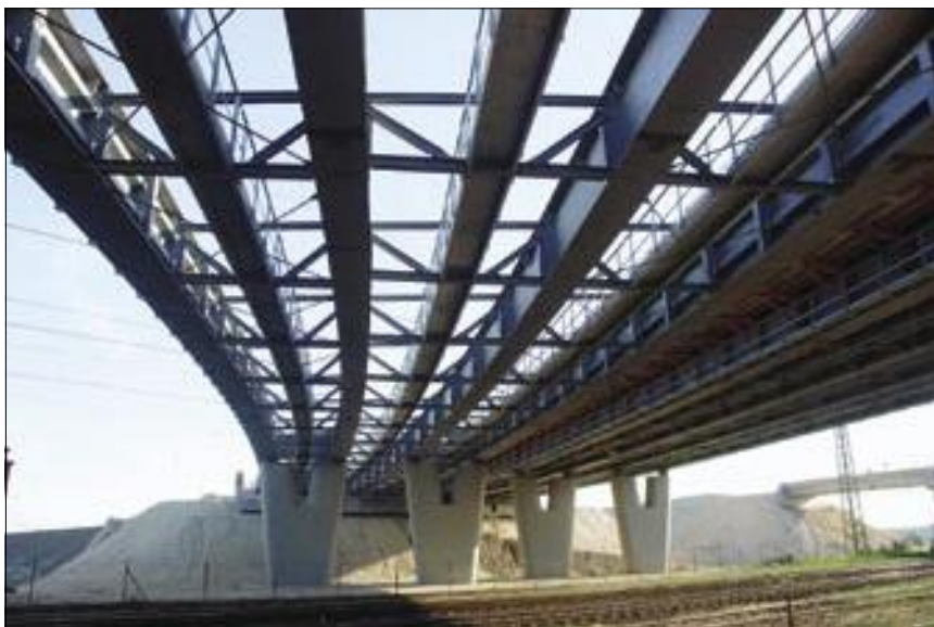
3. kép: A felszerkezet a szerelés során: az acél főtartók és vizsgálójárdák még a vasbeton pályalemez zsaluzási munkáinak megkezdése előtt
