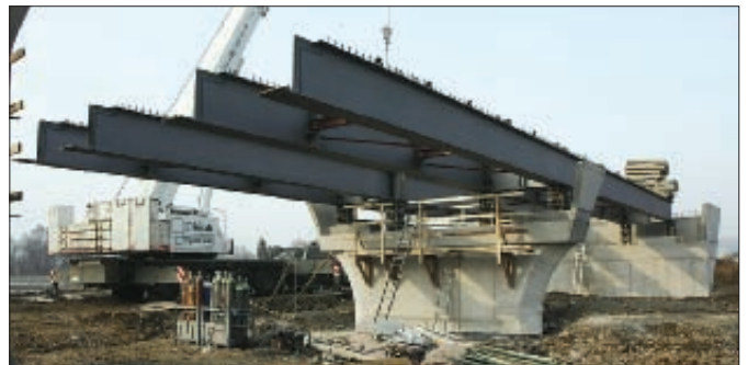
16. kép: II. jelű gyártási egységek a „D”-„E” támaszokra emelve, a hídfő felett leterhelve
