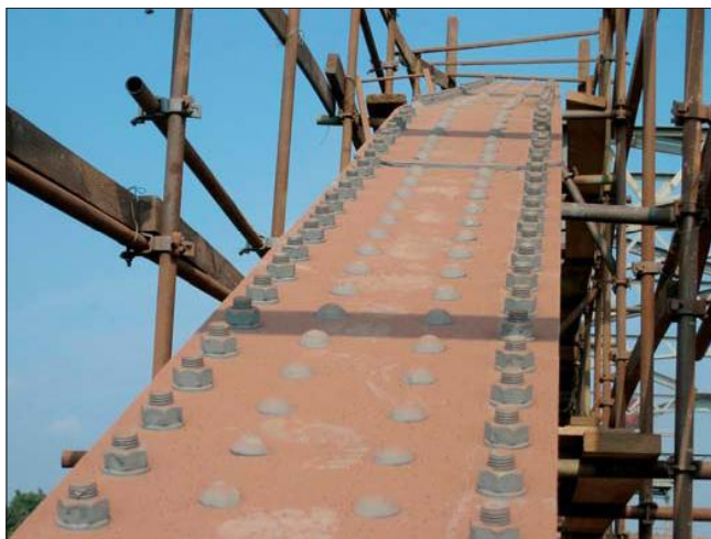
4. kép: A rácsos főtartó felső övének erősítése a régi szegecsek kifűrésével, új erősítő szögvas felcsavarozásával a felső övelemekre
