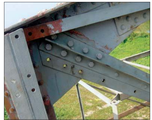
8. kép: Rácsrúdbekötés, ideiglenes állapotban, megfigyelhető, hogy a szegecsek helyett már csavarok vannak, tehát ez már az utolsó előtti fázis az erősítő szelvény felhelyezése előtt
